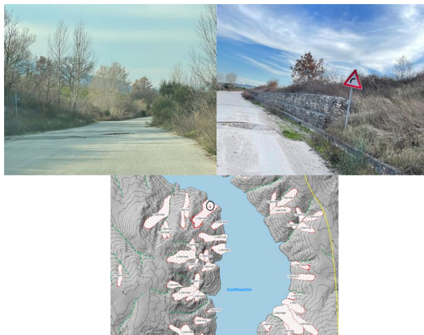
Figura 4.17 In alto a sinistra: danneggiamento e ondulazione del manto stradale. In alto a destra: interventi di consolidamento con evidenti segni di ammaloramento (si distinguono le ondulazioni delle gabbionate). In basso: indicazione con il simbolo nero del punto e dell'orientazione delle foto
